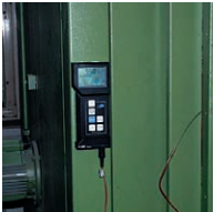
Temperaturkontrolle an Industrieöfen (z. B. Einbrennöfen)
